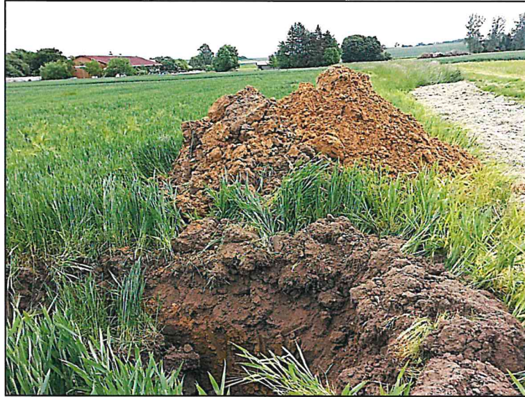
Schurf 3, Zusammenfallen ca. 30 Minuten nach Aushub, Blick nach Ost
